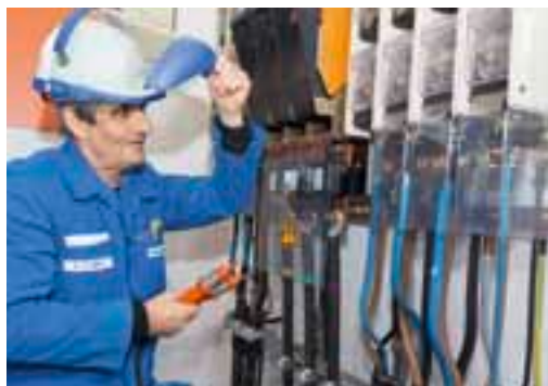
Regelmäßig kontrollieren und warten die Netzmonteure auch die Trafo- und Ortsnetzstationen.
